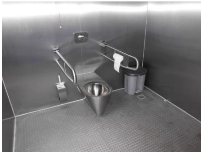
Abb. 20: WC im Ausstellungscontainer
