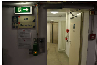
Beschilderung, Bedienelemente in Tiefgarage
