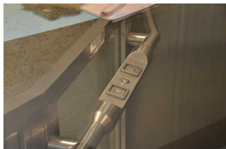
Hublift am Eingang
